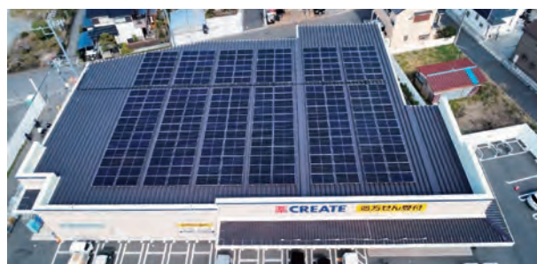
屋上に設置した太陽光パネル
