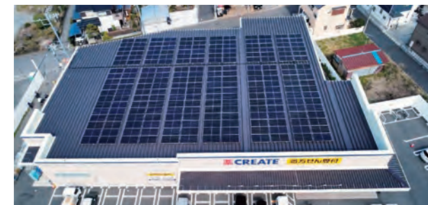
屋上に設置した太陽光パネル
