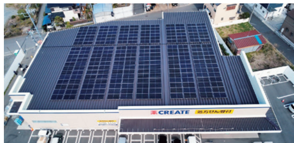
屋上に設置した太陽光パネル
